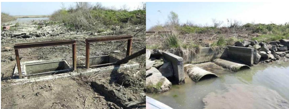
Tubi di collegamento sostituiti dalla chiavica a tre luci.
