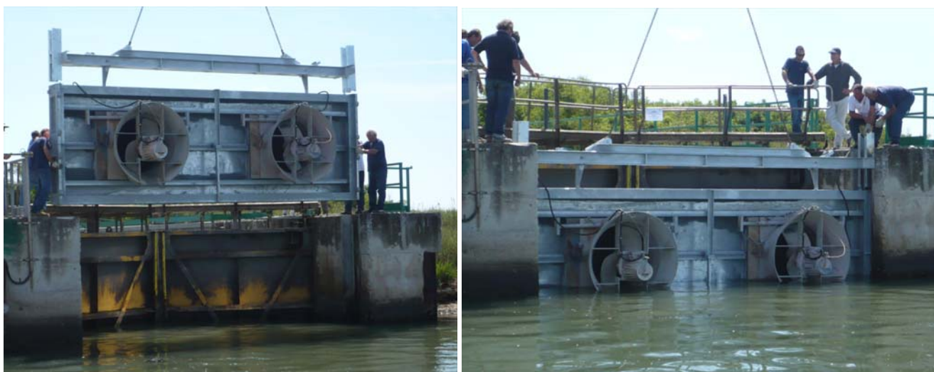
Figura 10 – Installazione del telaio appositamente realizzato per supportare le 2 pompe Flygt nella conca di navigazione di Gorino
