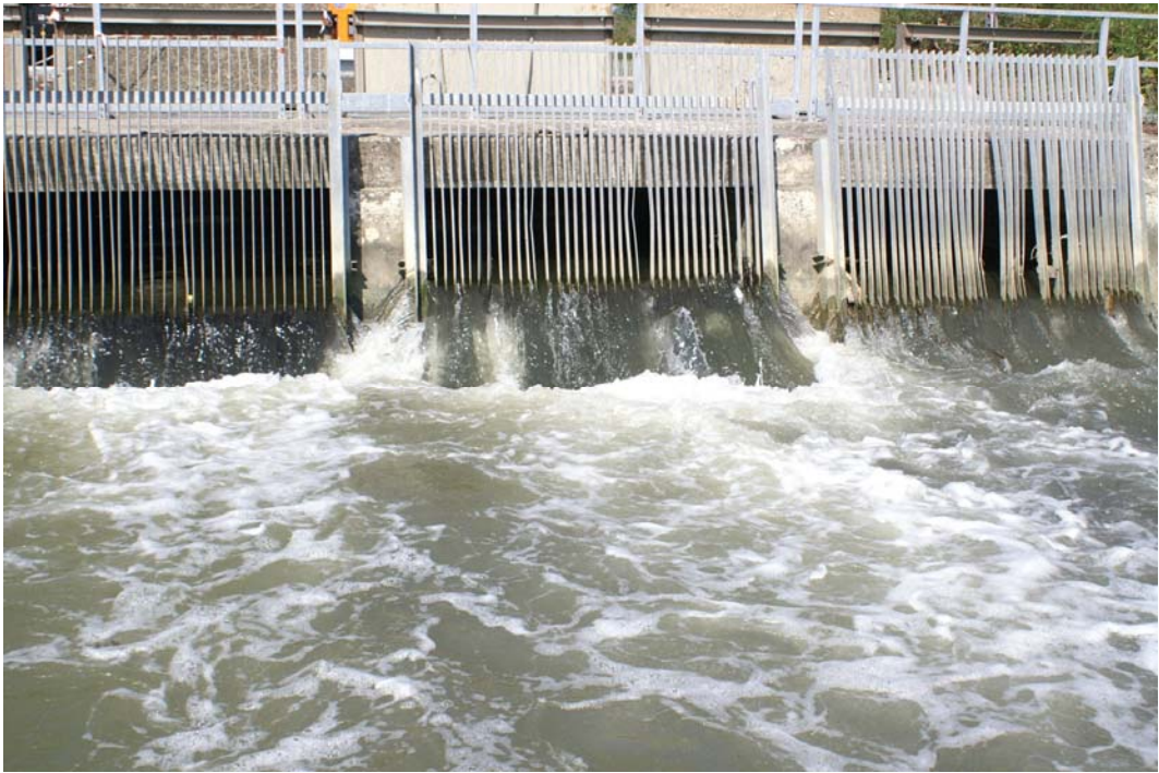
Figura 13 – Idrovora Lanterna Vecchia (lato Fiume Po di Goro) – Fuoriuscita dell'acqua
